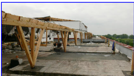
Poškodená sedlová strecha po veternej smršti 9. júna 2012
