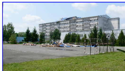
Poškodená sedlová strecha po veternej smršti 9. júna 2012
