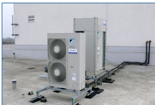
Klimatizácia na DSS – vonkajšia jednotka
