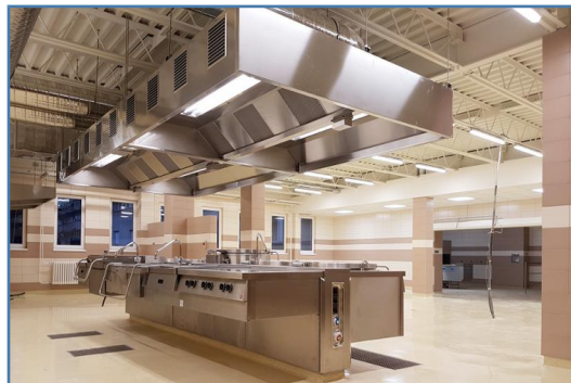
Vzduchotechnika pre varný ostrov
