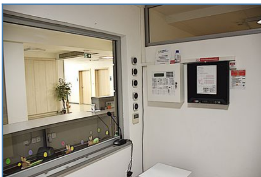
Panel elektropožiarnej signalizácie a hlasovej požiarnej signalizácie
