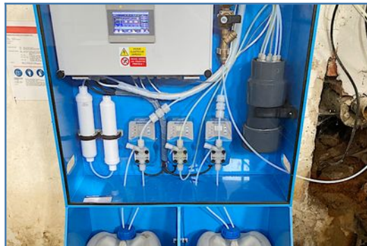
Technologické zariadenie pre úpravu pitnej vody proti legionellam
